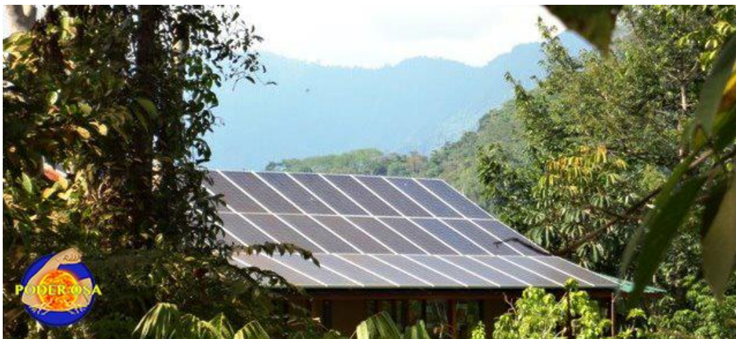
10.6 Kilowatt solar grid tie, Hatillo.
